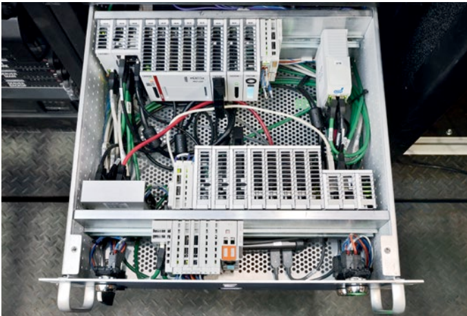
Als Mastersteuerung dient ein Embedded-PC CX2030. Zusammen mit weiteren Embedded-PCs des Typs CX5100 erbringt er die notwendige Rechenleistung für die Steuerung der komplexen Bühnentechnik.
