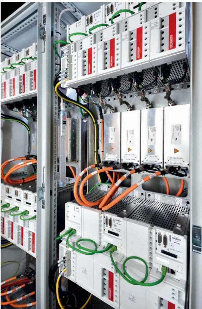
Jede Bühnenshow lebt von Aktionen und spektakulären Effekten: Für die Bewegungssteuerung nutzt Hudson Scenic die Servoverstärker AX5000 und die Synchron Servomotoren AM8000 mit OCT.
