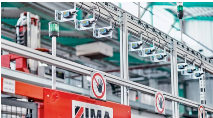
Über die TwinSAFE-SC-Klemmen werden die Analogsignale von insgesamt 36 Lichtlaufzeitsensoren erfasst.
