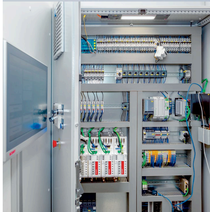
Der Blick in den Schaltschrank zeigt den Ultra-Kompakt-IPC C6030 und die angereicherten EtherCAT-Klemmen (Mitte rechts) sowie die Servoverstärker AX5000 (unten) und das 12-Zoll-Multitouch-Control-Panel CP2912 (links).
