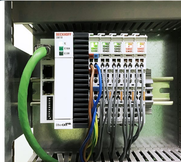
Beckhoff Embedded-PC CX8110 mit analogen EtherCAT-Eingangsklemmen EL3182 für HART-fähige Feldgeräte
