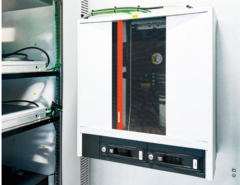
Der leistungsstarke Schaltschrank-Industrie-PC C6675 bildet den Kern der Steuerungslösung für die neue ZF-Produktionslinie.
